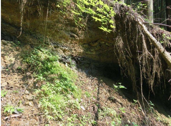
4 崩壊面頭部に見られる破碎帯の接写。
