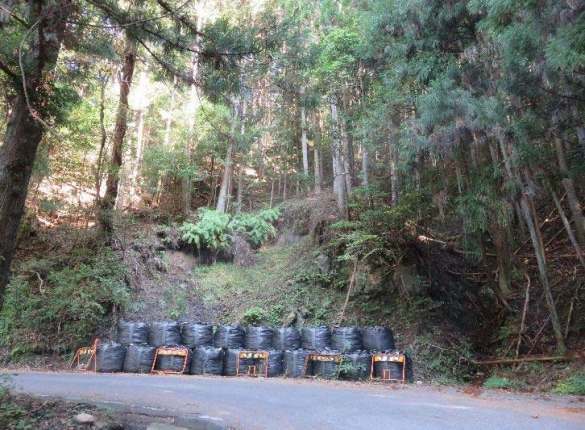
2 ヘアピンカーブにおける地すべりと大型土囊による土砂流出対策。SL-4の包括的地すべりの素因となっている緩傾斜破碎帯が分布する。
