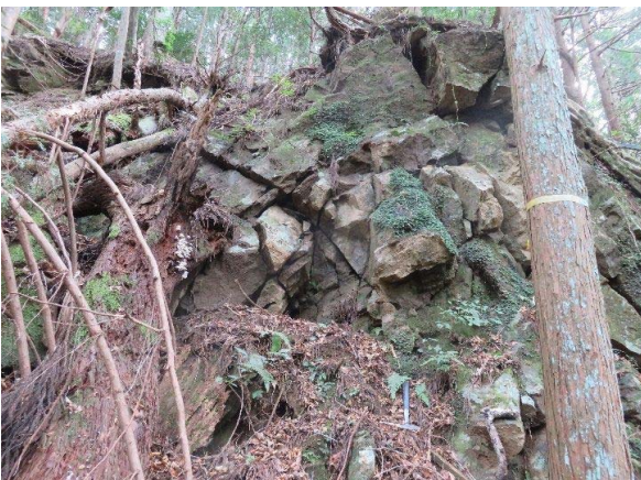
25 浅層すべり土塊の一部を構成する崩壊地頭部の緩んだ岩盤。せり出しが見られる。
