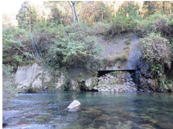
64 町道平野松戸線の川側盛土は護岸工が構築されているが、基礎洗掘が進んだ箇所も複数認められる。
