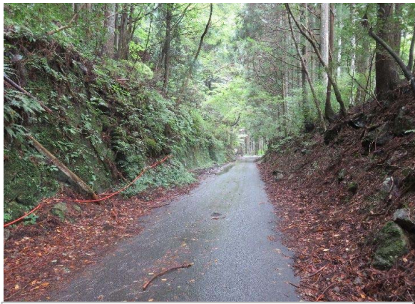
18 切割の山側は、空石積みによつてのり面保護されているが、常時の湧水と押し出し変形が見られる。
