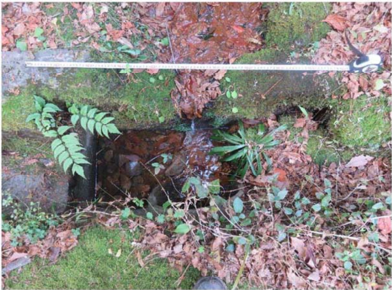
コンクリート堰からの流水の落下状況。標尺1m。 SD-4
