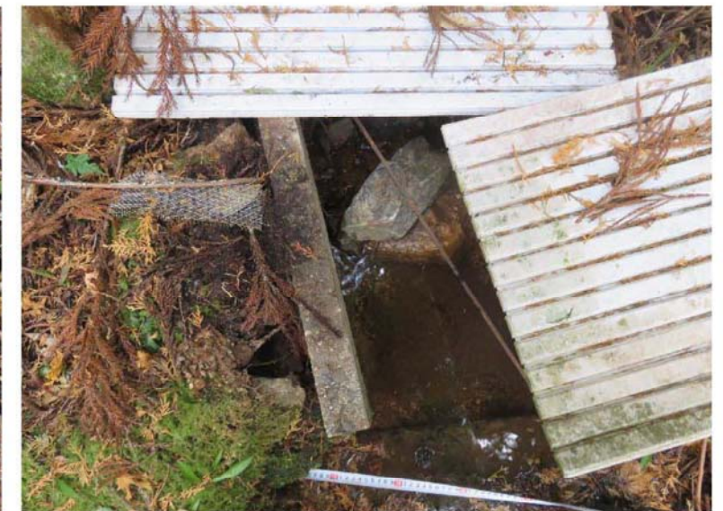
石(重し)の下の取水口。下流のパイプに接続している SD-2
