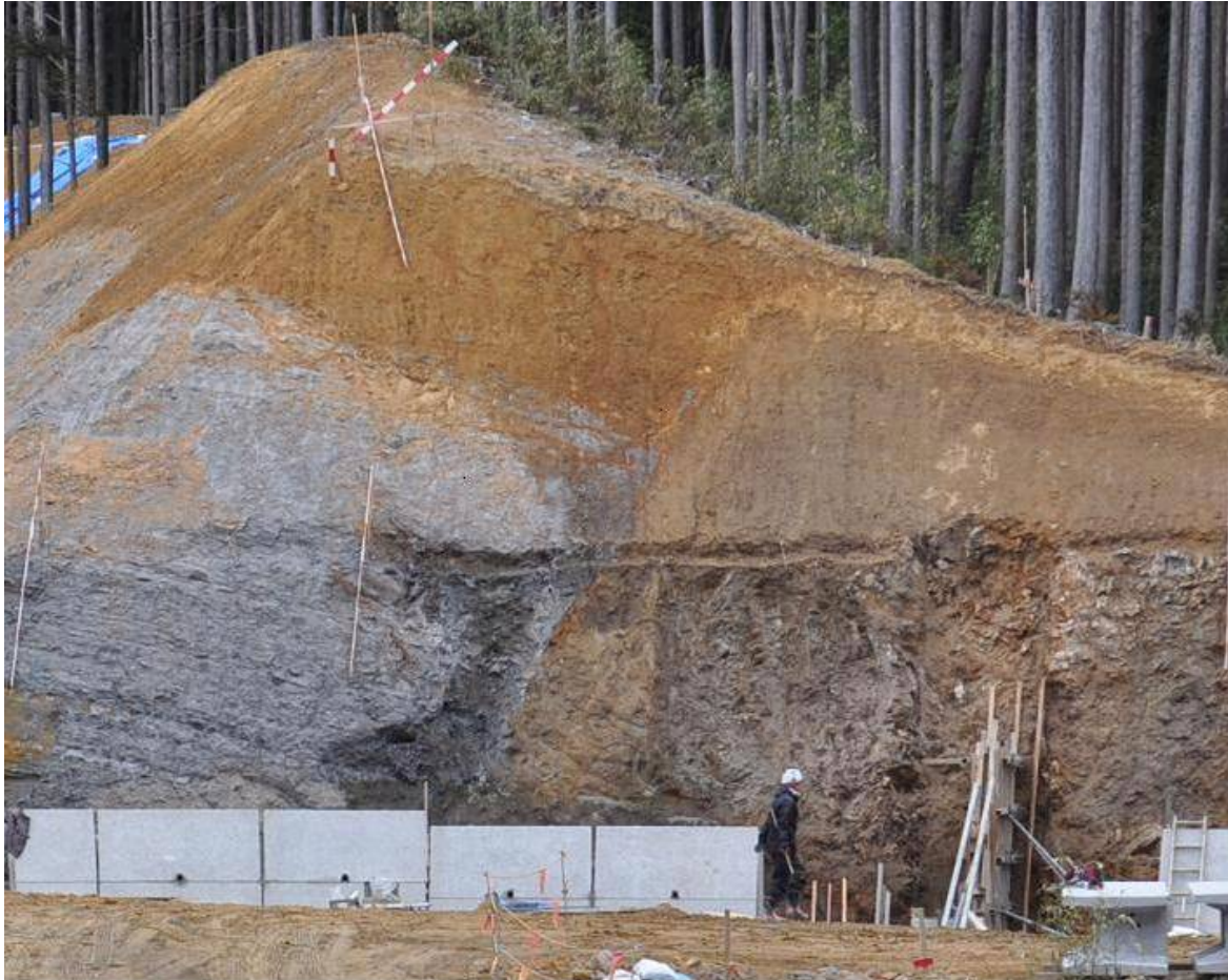
写真2 田口南西部の道路工事現場で見つかった断層露頭、風化層まで変位しているように見える。
